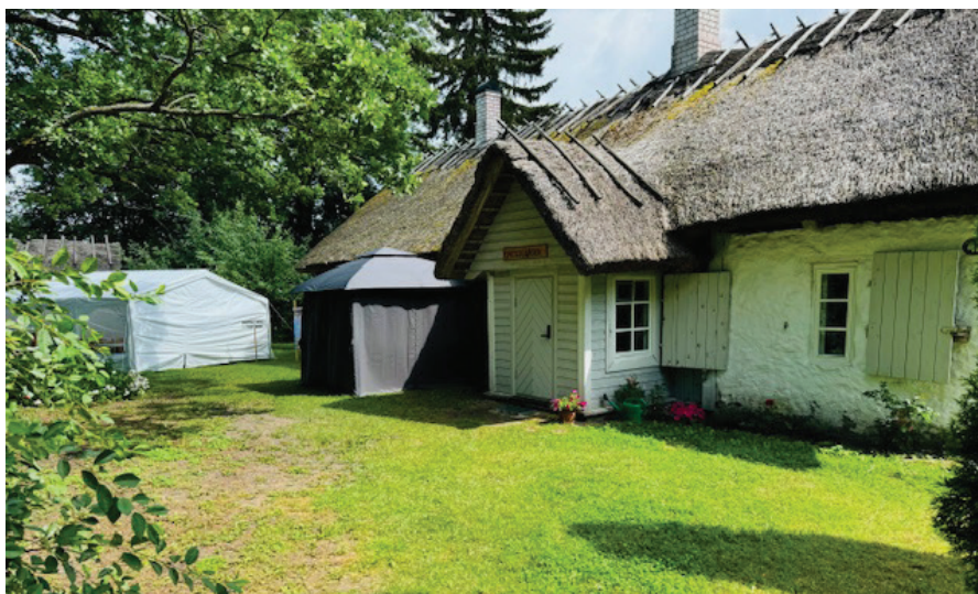
Storstugans tak är ett av de som är i behov av omläggning.
